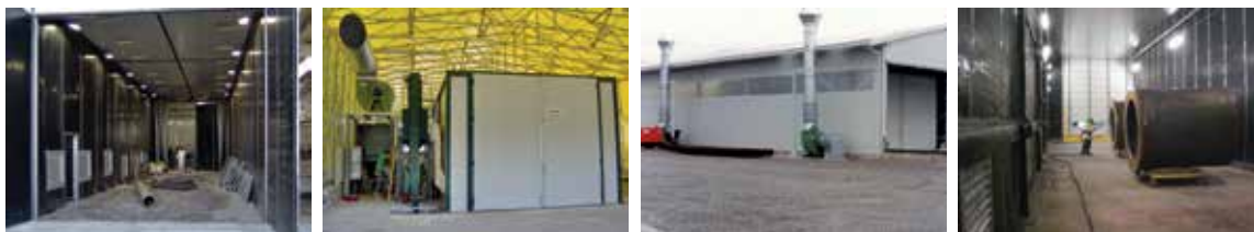
Collocazione interno fabbricato con tramoggia di carico fuori pavimento (a pala)
