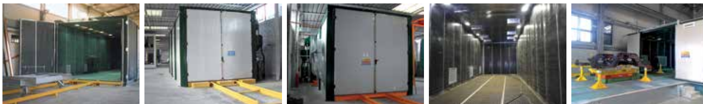
Collocazione interno fabbricato con basamento e binario
