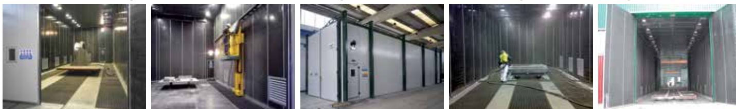
Collocazione interno fabbricato con raschiatori e coclea
